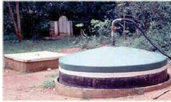
Figura No. 8. Digestor tipo hindú.
