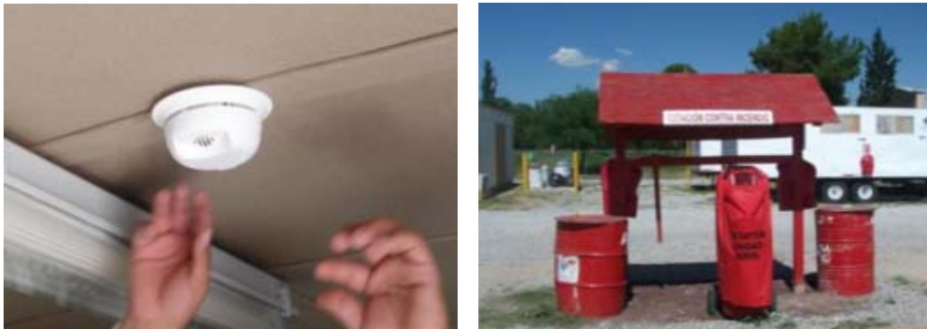
Detectores de humo y estación contra incendio.
