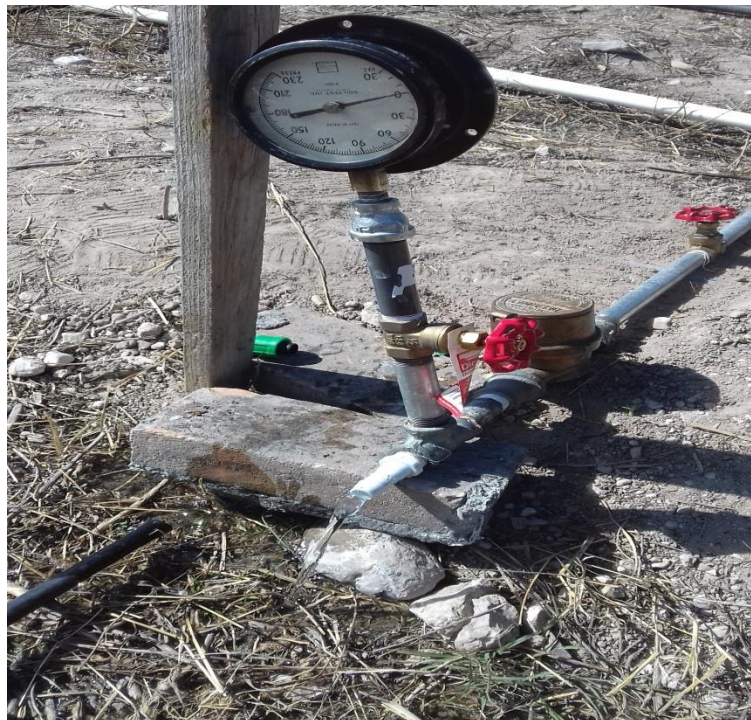
Figura 3.8. Conexión de Línea Principal y Cinta de Goteo Pasando por el Medidor y el Manómetro para Toma de Datos.
