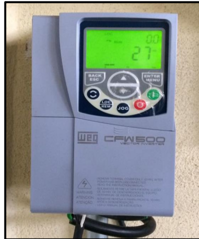
Figura 5.12 Variador de frecuencias.
