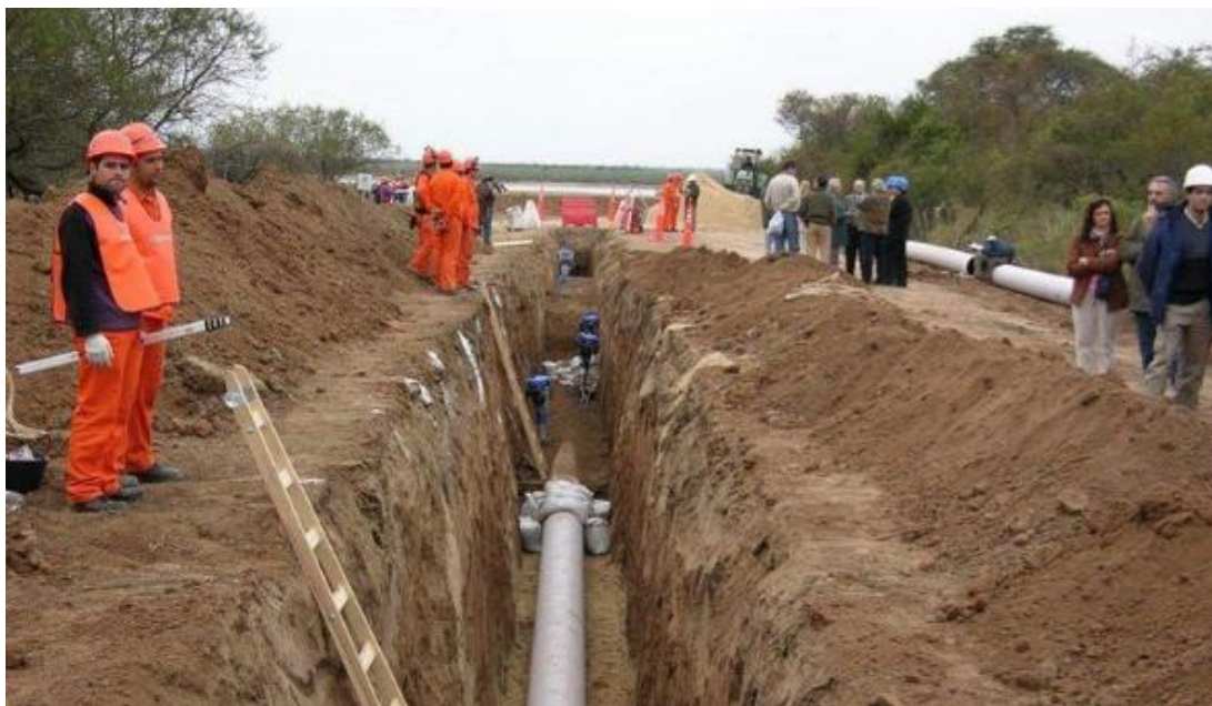
Imagen 1. Gasoducto. Fuente sipse.com
