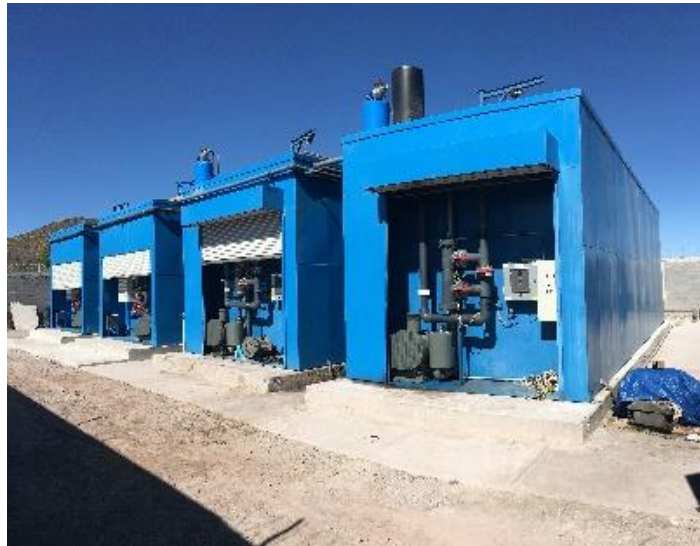
Figura 6. Vista panorámica de la PTAR-Hacienda Narro.
