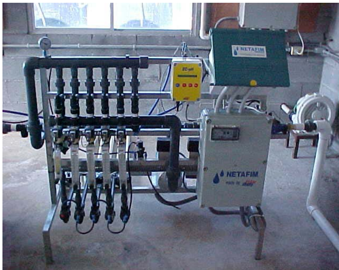
Figura 3.3. Equipo de fertirrigación automatizado (FERTIGAL).
