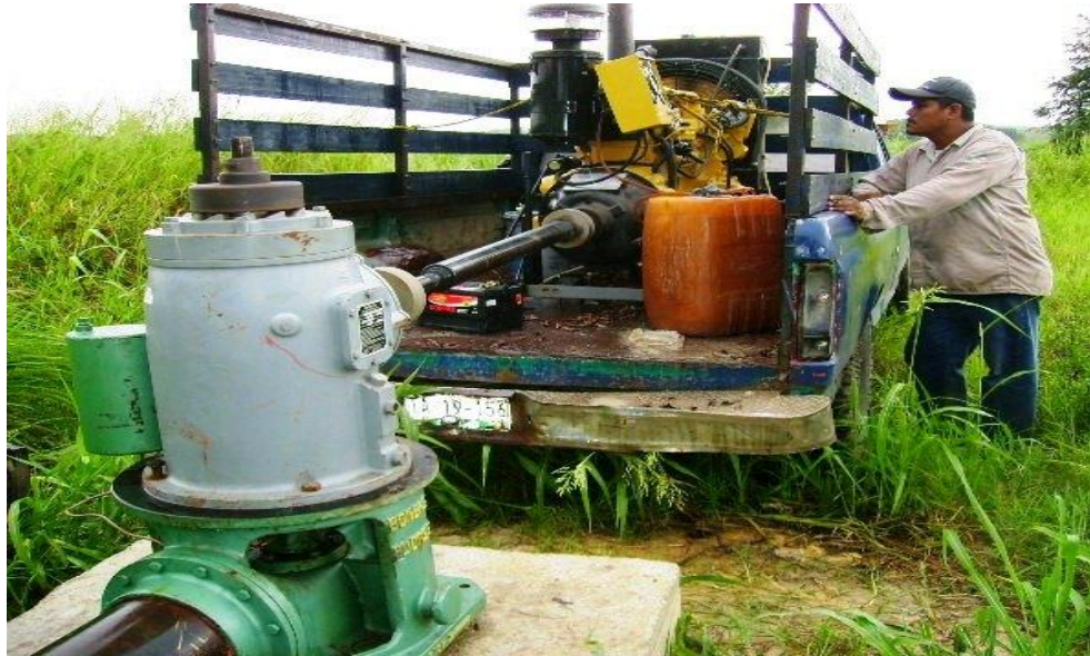
Motor y bomba operando
