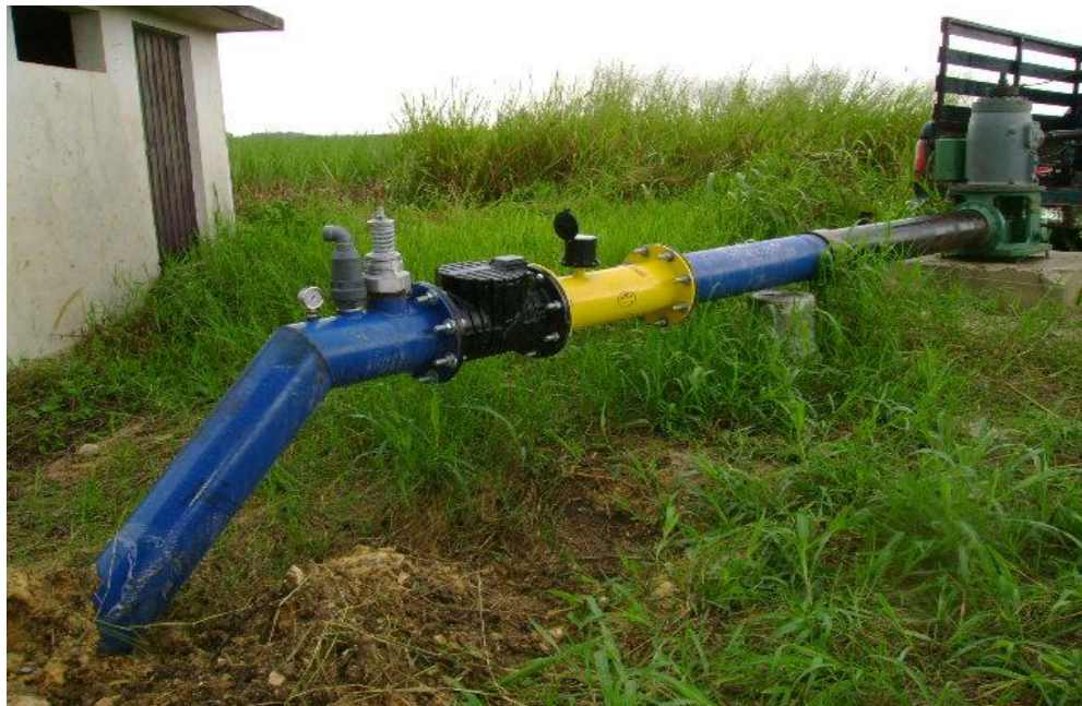
Cabezal de descarga con elementos de seguridad y medidor de Gasto
