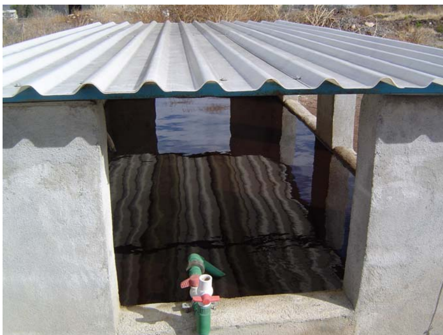
Figura 18. Recolector del humus líquido para su oxigenación y evaporación
