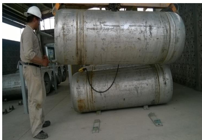
Figura 4.3.1. Cuarto de Cloración.
