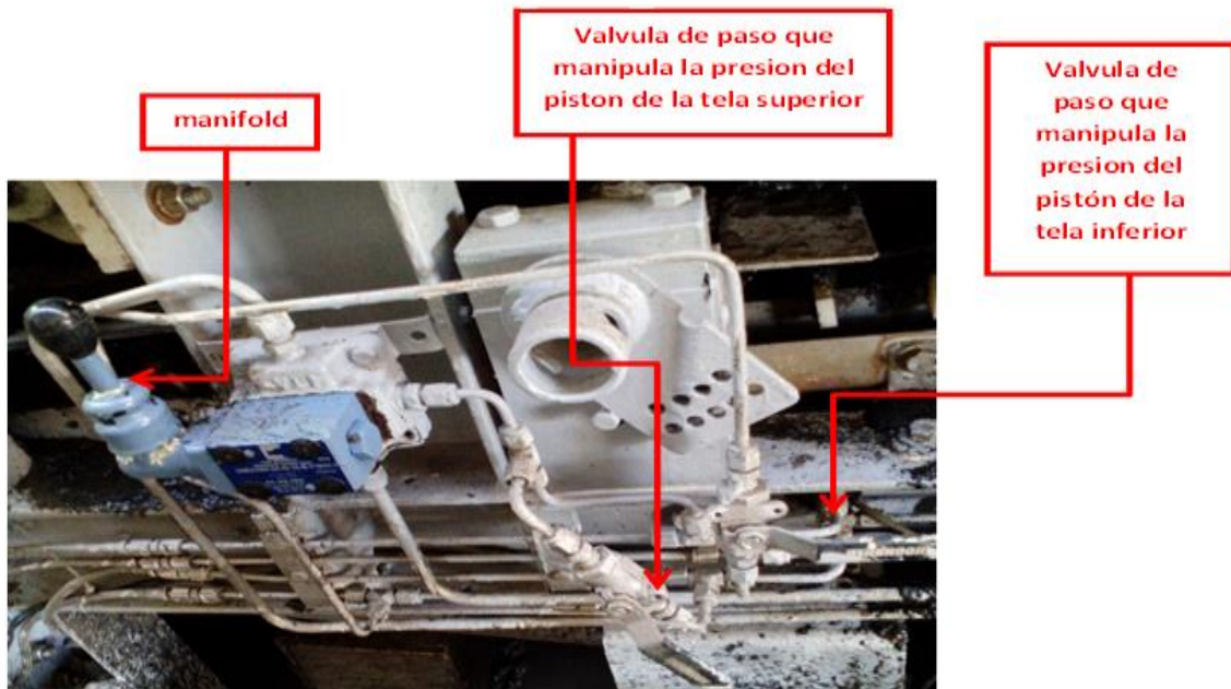
Figura 7.2.6.1. Manifold y válvulas.
