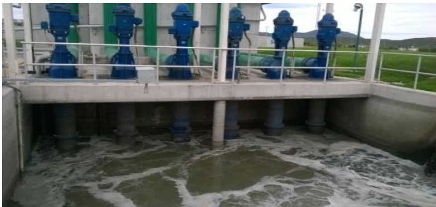
Figura 1.6.1. Cárcamo de Bombeo.
