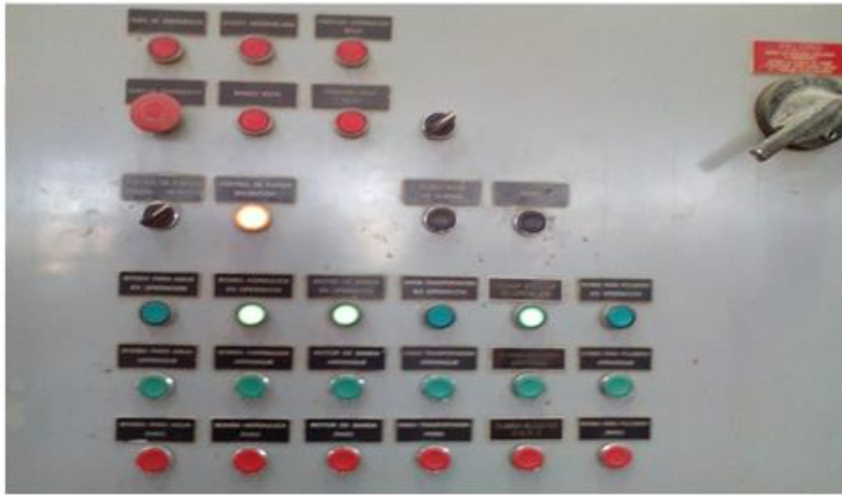
Figura 7.2.5.6. Tablero de filtros banda.
