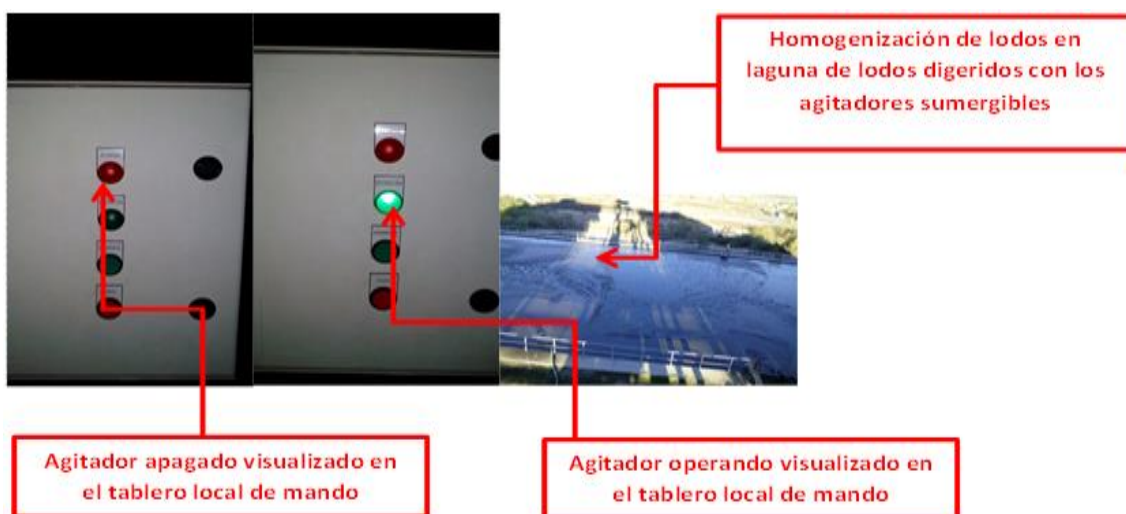
Figura 7.2.5.3. Tablero de los agitadores en la laguna.
