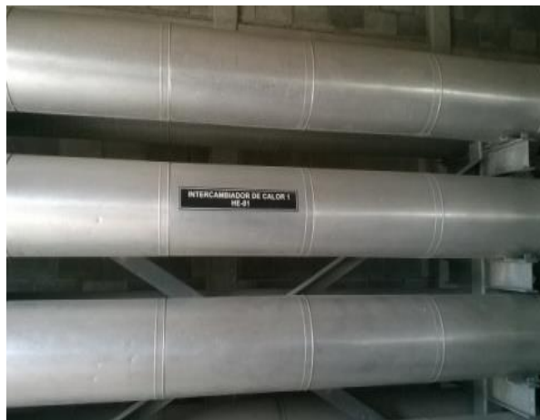
Figura 6.3.1. Intercambiador de Calor.
