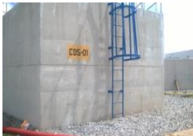
Figura 2.1.1. Caja de Distribución Primario.
