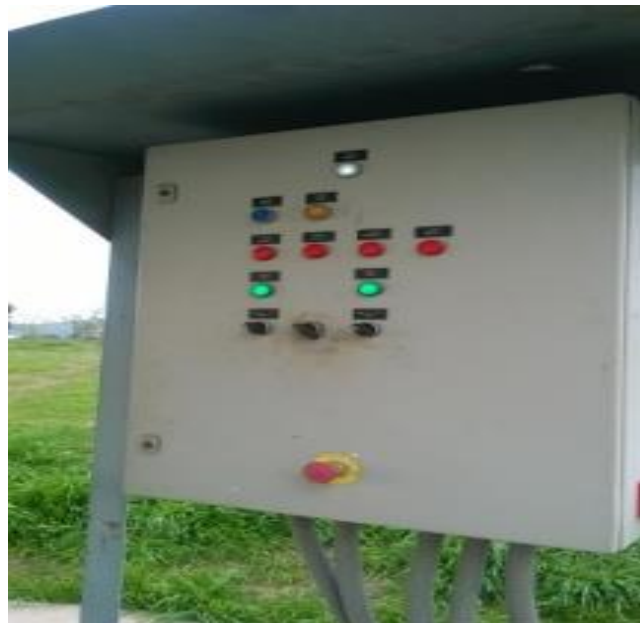
Figura 1.4.3. Tablero de las Rejillas Finas.
