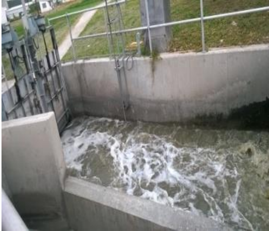
Figura 1.2.1. Caja de Excedencias.
