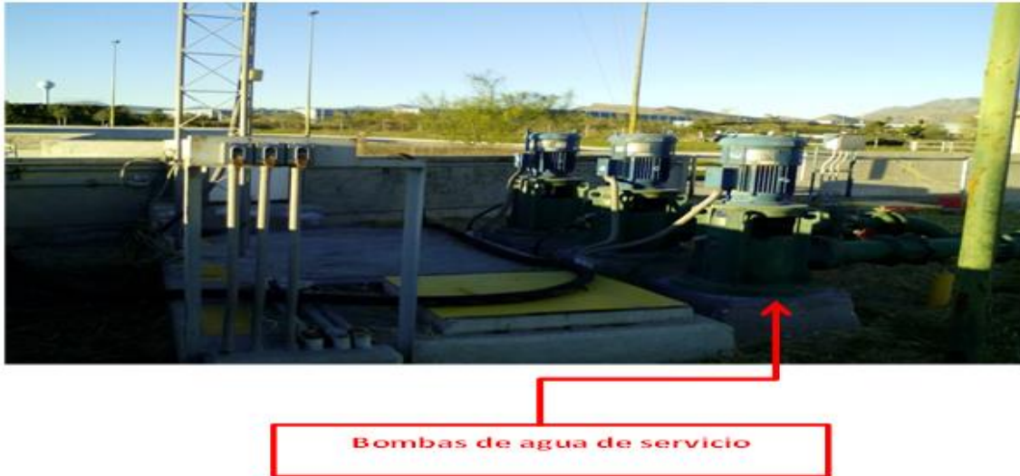
Figura 7.2.1. Bombas de agua de servicio.
