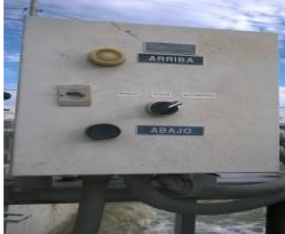
Figura 1.2.2. Tablero de la Compuerta.
