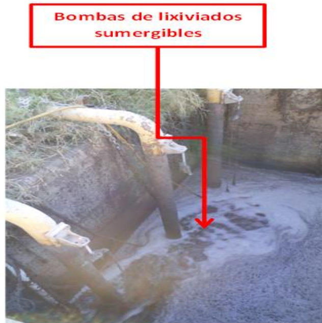
Figura 7.2.3.1. Bombas de lixiviados.
