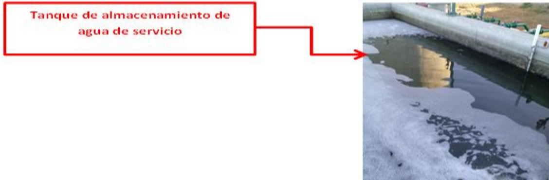
Figura 7.2.1. Tanque de almacenamiento.
