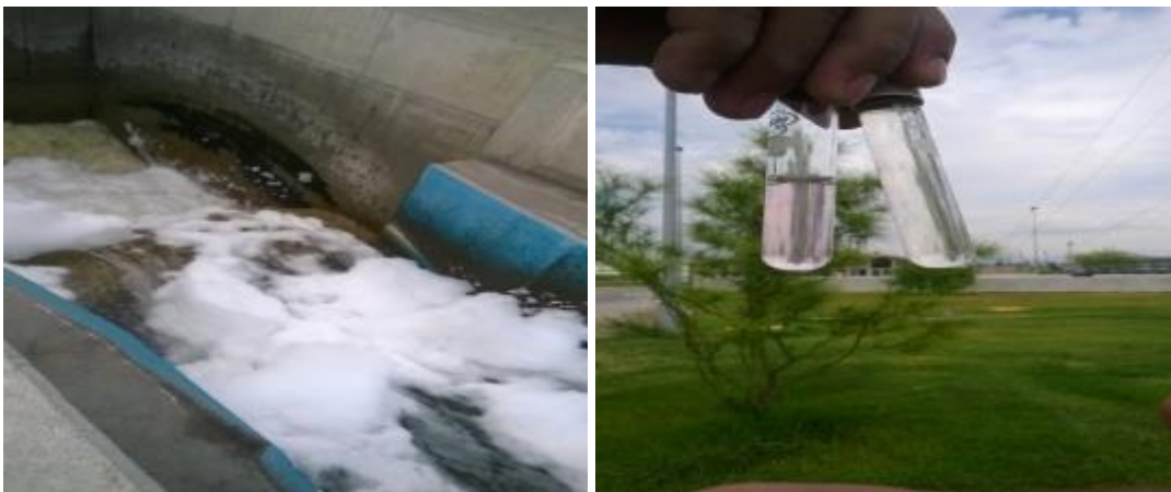
Figura 4.2.1. Canal Parshall del efluente. Figura 4.2.2. Cloro Residual.
