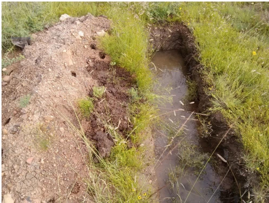
Figura 17. Zanja trinchera favorecen a una mayor infiltración de agua, retienen y conservan humedad para el establecimiento de la reforestación, Ejido Trancoso, Trancoso, Zacatecas (Fotografía tomada por Santiago Aguilar, 2014).
