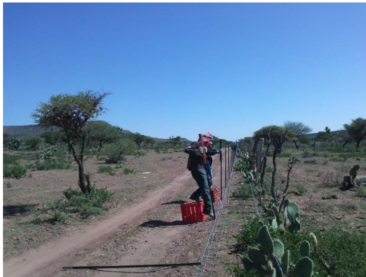
Figura 6. Instalación de cerco con postes de fierro Ejido Trancoso, Trancoso, Zacatecas (Fotografía tomada por Nicolás Aguilar, 2012).
