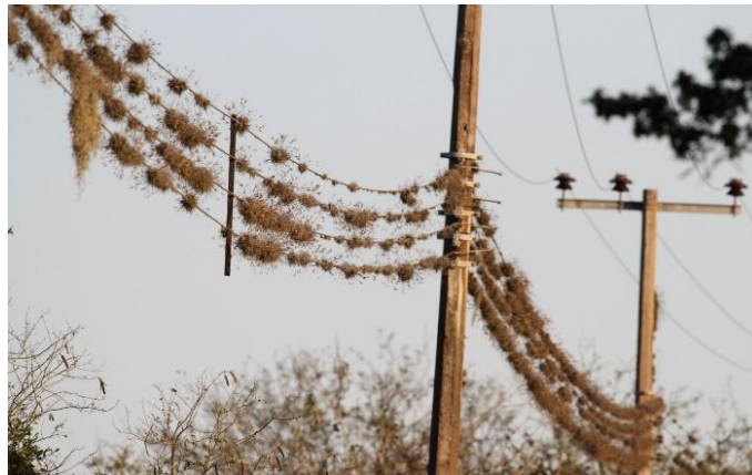
Imagen 11. Cableado de la electricidad infestado por T. recurvata , en Tamaulipas, México.
