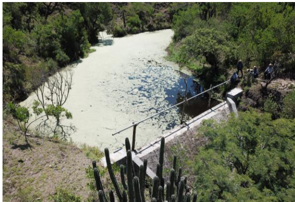
OBRA: Presa de concreto. LUGAR: Atotonilco, Ciudad Fernández, San Luis Potosí. FOTOGRAFÍA: Lic. Sergio Salvador García Rivera
