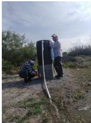
Figura 30.- Humedal sin grava funcionando.
