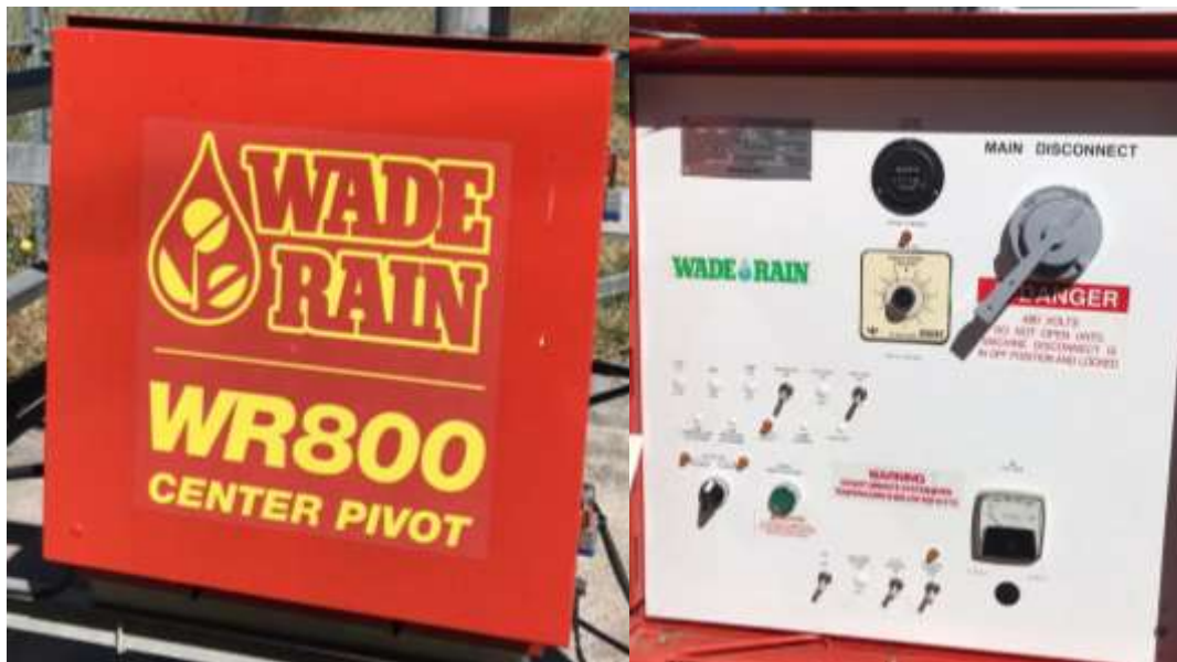
Figura 6.- Tablero controlador eléctrico.
