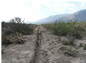
Línea de conducción
