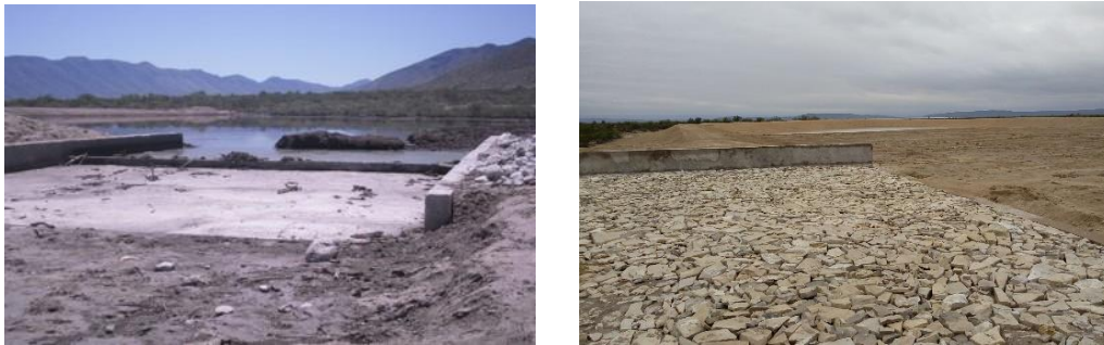
Imagen 28. Vertedores de demasías en bordos de tierra compactada para abrevadero
