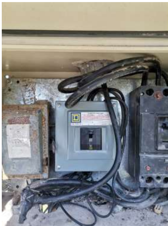
Imagen 25 Alimentación principal del sistema eléctrico
