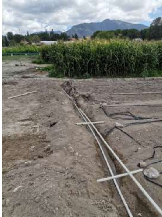
Imagen 19 Conexión de línea secundaria y mangueras regantes de ambas unidades
