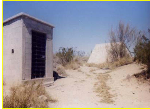
Pila de almacenamiento del pozo anterior
