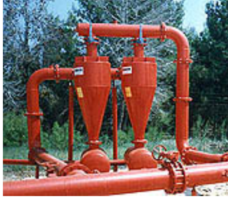
Figura 22. Hidrociclones instalados en paralelo.
