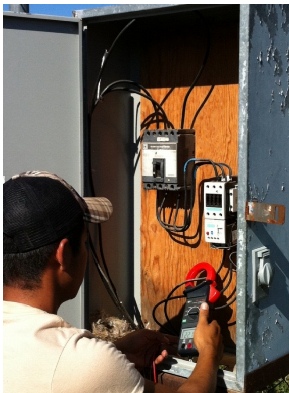
Figura 4.5. Levantamiento de datos eléctricos.
