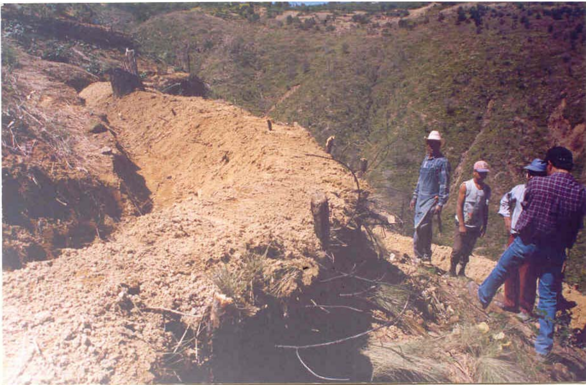
Figura 14. Detalle de la zanja y el bordo del sistema de terrazas de formación sucesiva
