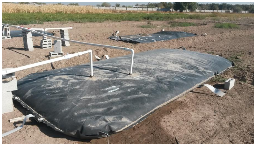
Figura 9. Reactor presentando una pequeña fuga del líquido. Fue necesario vaciar el reactor y reparar el daño.
