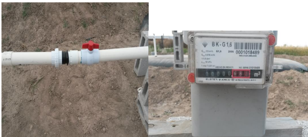
Figura 5. Colocación del medidor de biogás (flujómetro) y adicionar una válvula check de 2 pulgadas para evitar el regreso del gas del sistema de colecta.
