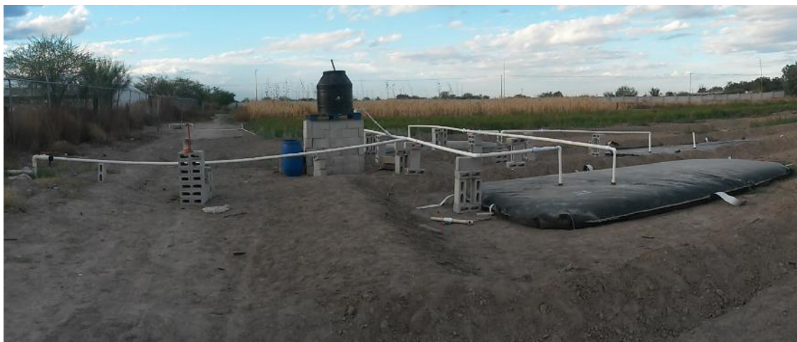
Figura 8. Vista completa del sistema instalado y funcionando para la producción de biogás.
