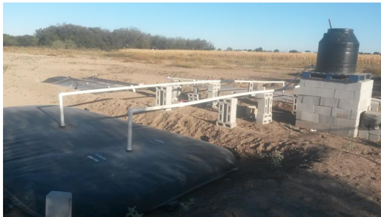
Figura 3. Ubicación e instalación de digestores, y sistema de alimentación en campo.
